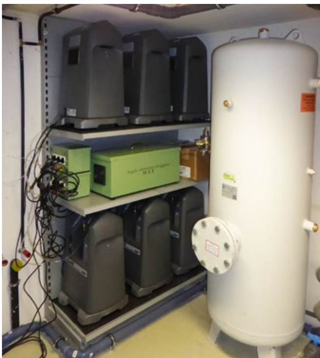
Mein HVO Sauerstoffsystem im Technikraum unseres Wohnhauses, das der Werkstatt angeschlossen ist.
